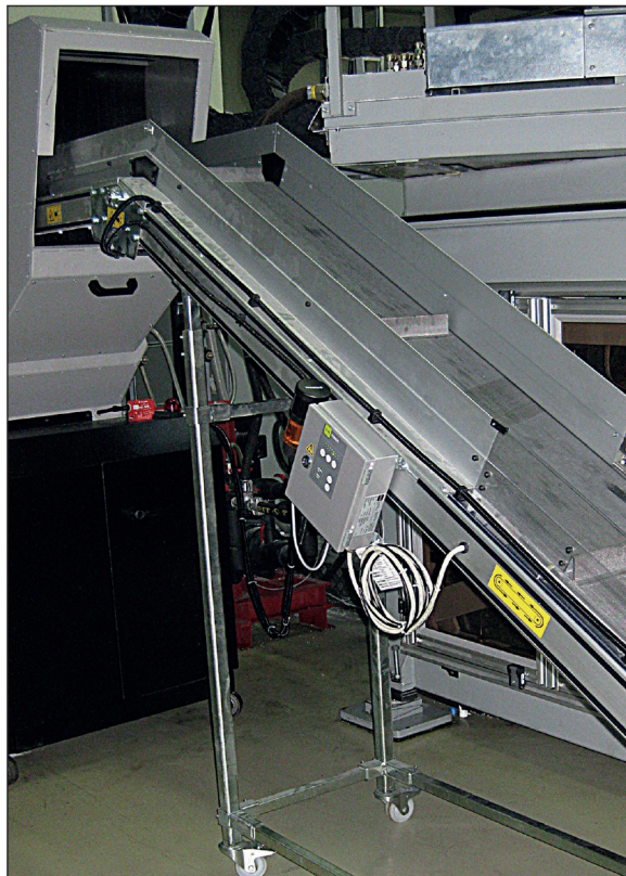
Ví dụ minh họa về việc lắp đặt: Bảo vệ máy móc. Máy dò kim loại ELCON được lắp đặt trên băng tải dẫn đến máy tạo hạt. (Phiên bản cũ)
